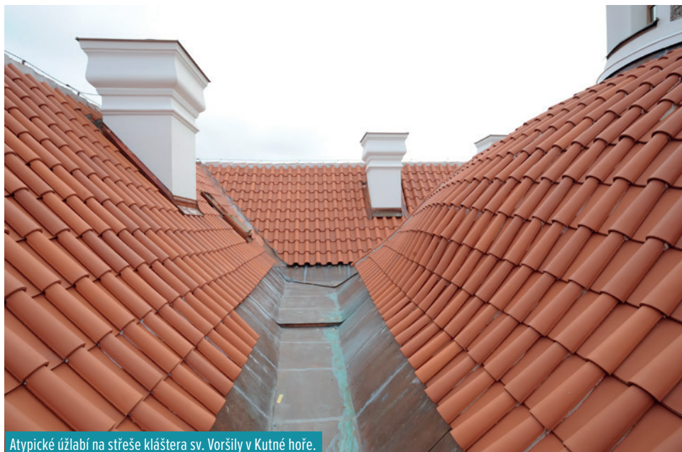
Atypické úžlabí na střeše kláštera sv. Voršily v Kutné hoře.
