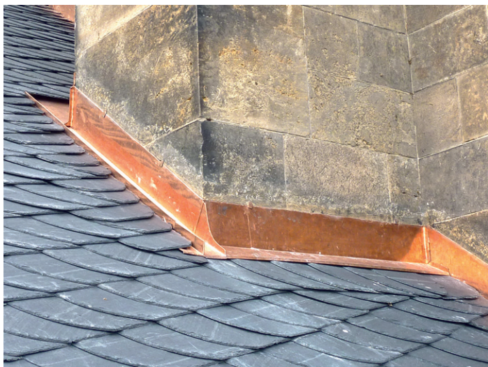
Nahoře původní stav, dole opravená střecha
